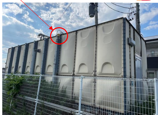
受水槽の例（FRP製）
