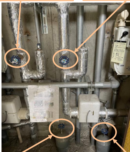
② 水抜弁(1,3,5号室)
