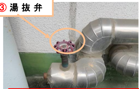
バルコニー 給湯器下の湯抜き弁
