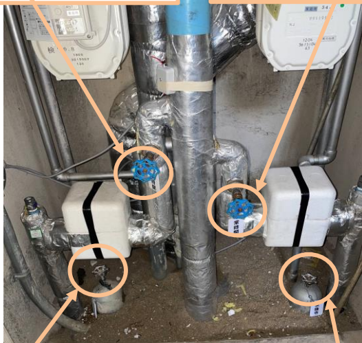
② 水抜き弁 (1,3,5号室)
