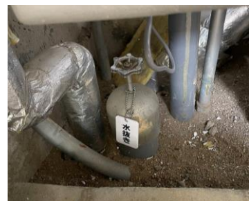
パイプシャフト 水抜き弁拡大
