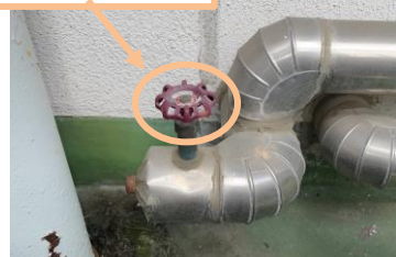
バルコニー 給湯器下の湯抜き弁
